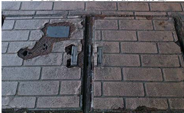
▲歩道が傷んでいると、高齢者がつまずくなど危険
