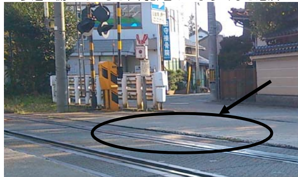
▲線路と道路の段差が大きく、車の振動などが大変
